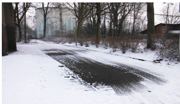
Op deze plek is er mogelijk een lekkage van de stadsverwarming
